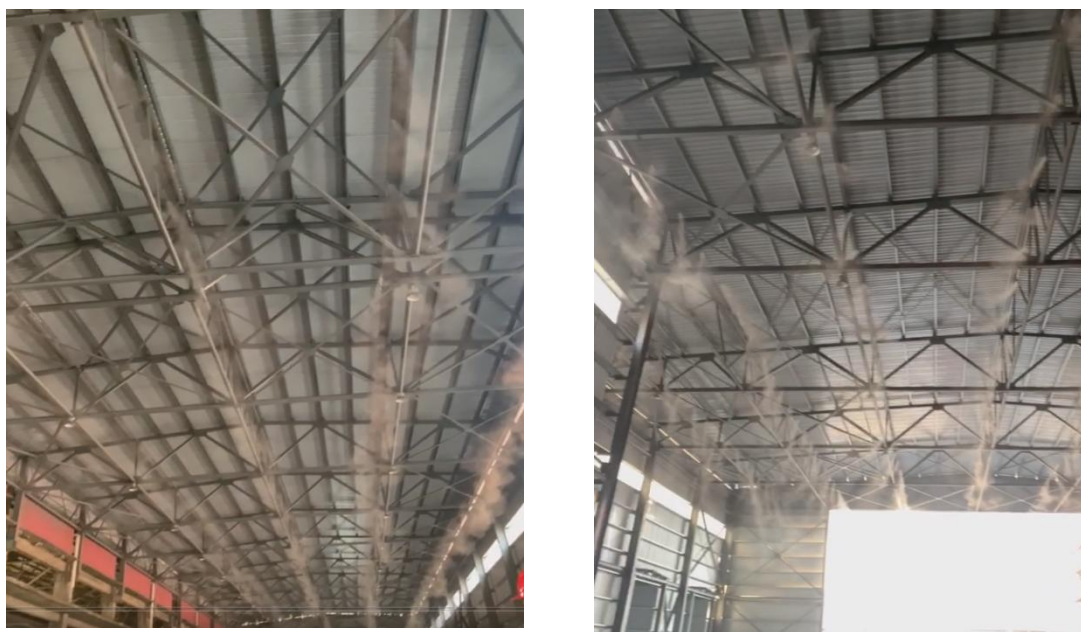
图 2.2-1 联合储库门口及主运输通道设置喷雾抑尘设施现场图
