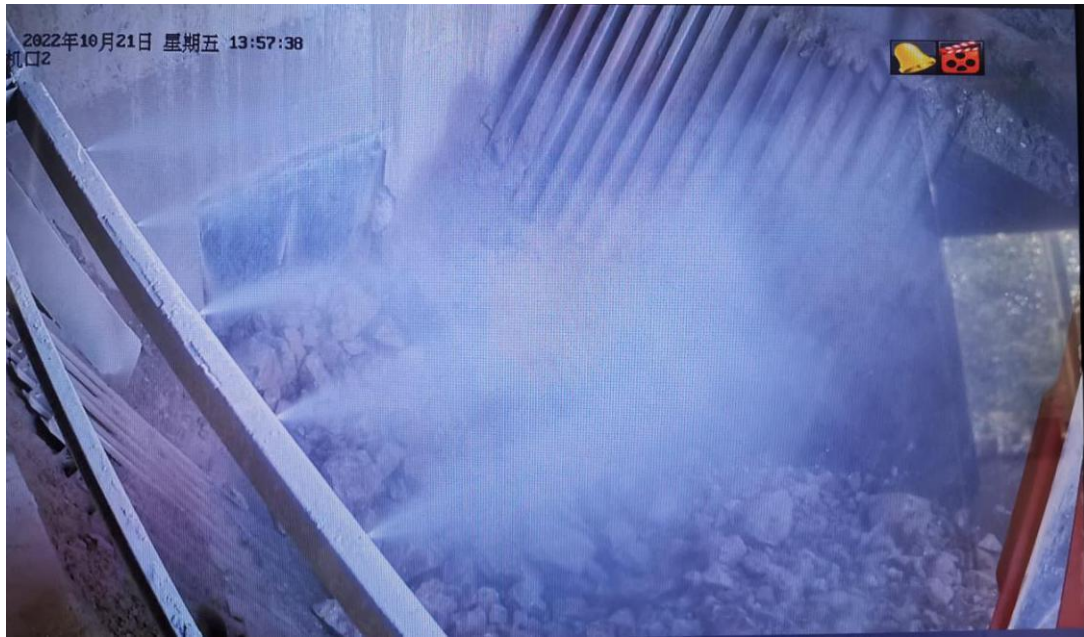
图 2.2-1 石灰石破碎卸料口喷雾抑尘设施现场图
