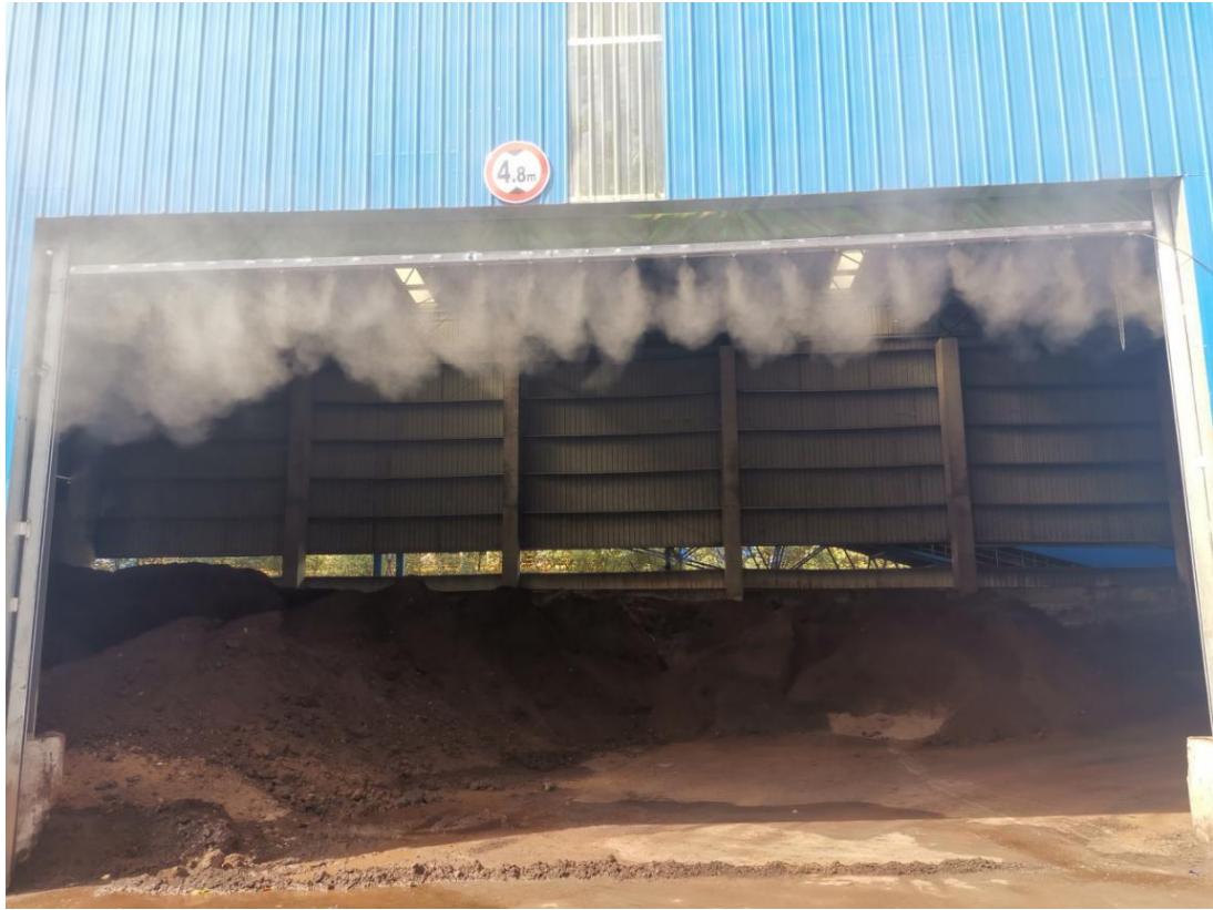
图 2.2-3 煤堆棚物流门口喷雾抑尘设施现场图
