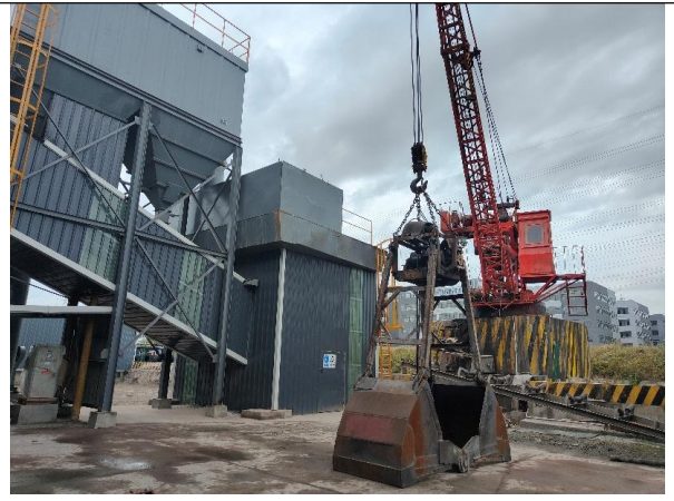
卸料斗、皮带均封闭，配收尘除尘，喷雾抑尘
