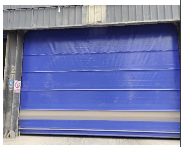
装车区域整体封闭，关门作业；设收尘除尘
